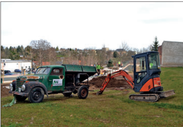
Ein neuer Stadtgarten entsteht an der Ecke August-Bebel-Straße / Augasse. Fotos: Hönsch
