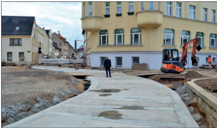
Für die Bachüberbauung des Dittrichbachs im Bereich Altmarkt / Am Merzenberg waren Ende April 2021 alle Fertigteileplatten verlegt. Bürgermeister Professor Dr. Ungerer informierte sich zum Baufortschritt. Fotos: Hönsch
