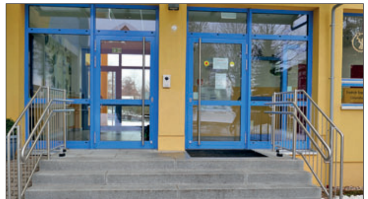
Im Schulgebäude der Grundschule Friedrich-Engels-Schule wurden eine Brandwarnmeldeanlage und eine ELA-Anlage installiert, die Haupteingangstüren wurden mit einer Türsprechanlage mit Videoübertragung ausgestattet. Fotos: Schule
